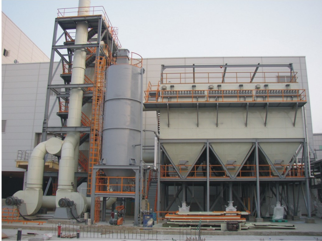
ACTUAL SITE VIEW OF 150 HP ID FAN
